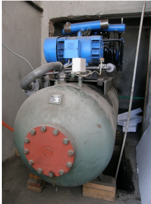
Слика 55 - Резервоар за складиштење отпадног моторног уља "Вуловић транспорт"
