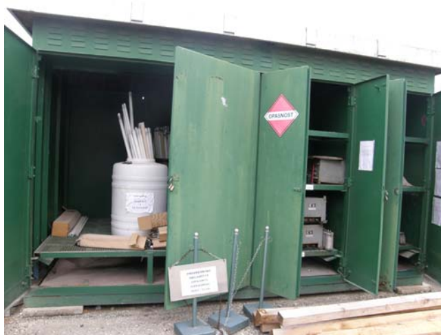
Слика 49 - Привремено складиште опасних отпадних материја "Електрошумадија" Крагујевац
